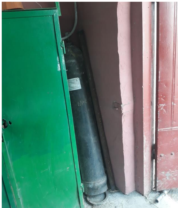
Нарушение порядка хранения баллонов с газом.
