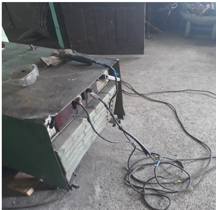
Отсутствует изоляция на электросварочных проводах в местах их соединения.
